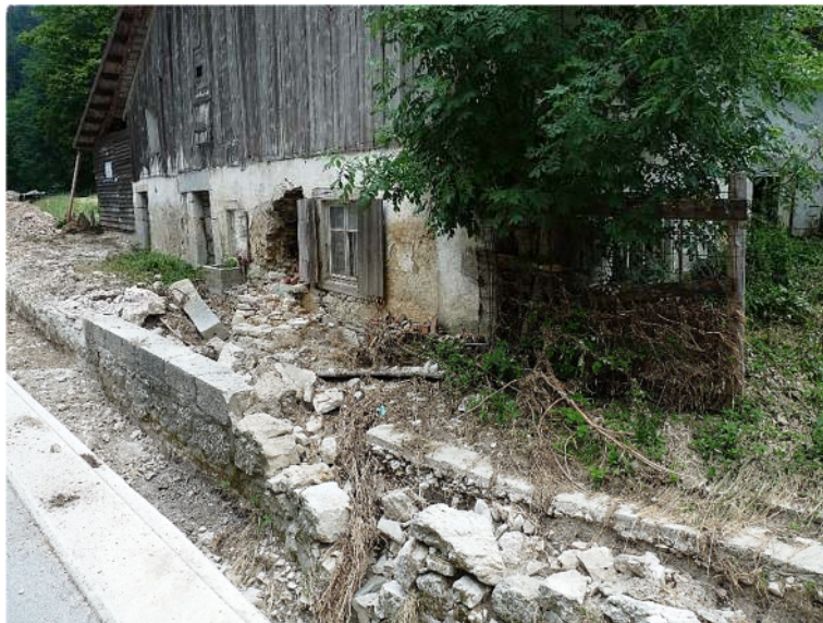
03.07.2019: Die aufgerissene Gerinneschale sowie das vom Wasser durchströmte und beschädigte Gebäude zeugen von der Gewalt des hochgehenden Ruz Chasseran. Das im Zaun rechts hängengebliebene Geschwemmsel markiert den erreichten Pegelstand. (Foto: VKG).
