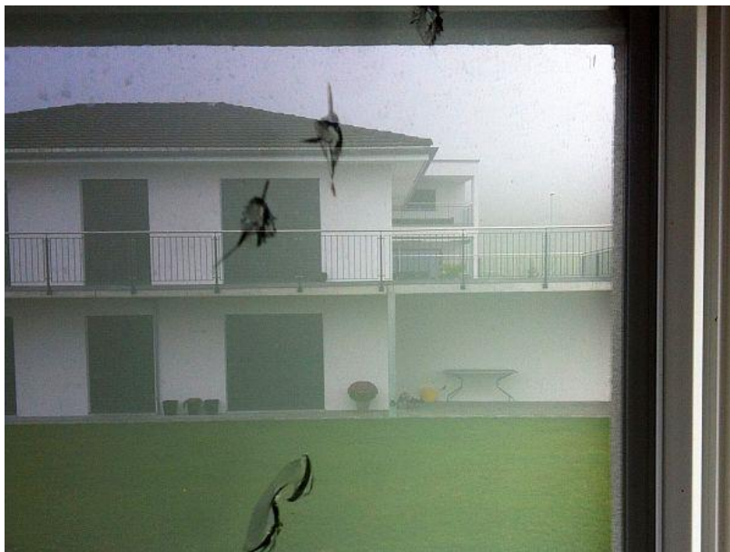
22.10.2104: Fenêtre à double vitrage endommagée par les galets que des bourrasques ont emportés d'une toiture-terrasse couverte de gravier à Riedholz SO (Photo : UIR / AEAI).
