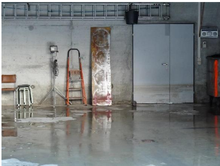
Inondation dans la zone industrielle et artisanale : au vu des traces sur le mur et les portes, l'eau est montée jusqu'à 60 cm dans cette halle pour véhicules. (Photo : UIR / AEAI, 12.01.2016)
