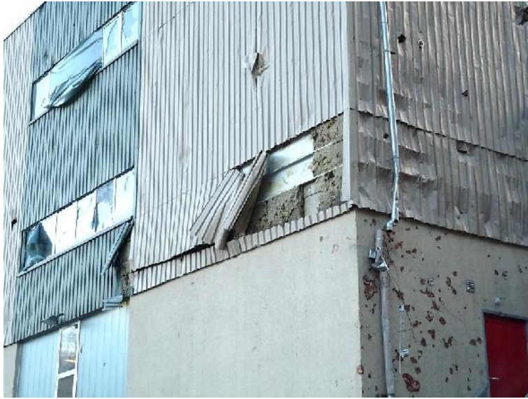
Bâtiment d'exploitation de l'entreprise de gravier et béton « Imbach » avec des dommages à la façade et aux fenêtres causés par les fragments de roche qui ont été projetés lors de l'impact de la masse qui a chuté. (Photo : UIR / AEAI, 12.01.2016)
