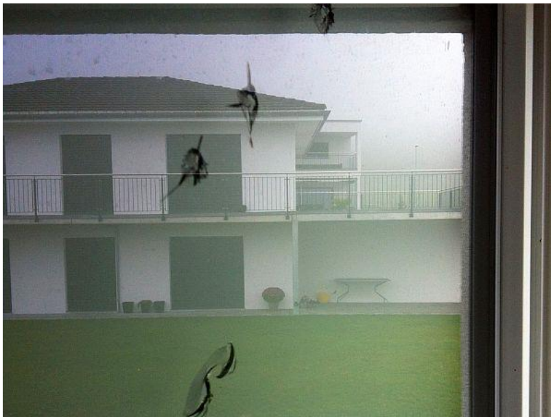
22.10.2014: Beschädigung an Fenster mit Doppelverglasung durch herumfliegende Kiesel von einer Flachdachbekiesung in Riedholz SO (Bild: IRV / VKF).
