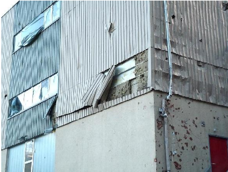
Betriebsgebäude des Kies- und Betonwerks «Imbach» mit Schäden an Fassade und Fenstern durch beim Aufschlag der Sturzmasse weggeschleuderte Gesteinsbrocken. (Foto: IRV/VKF, 12.01.2016)
