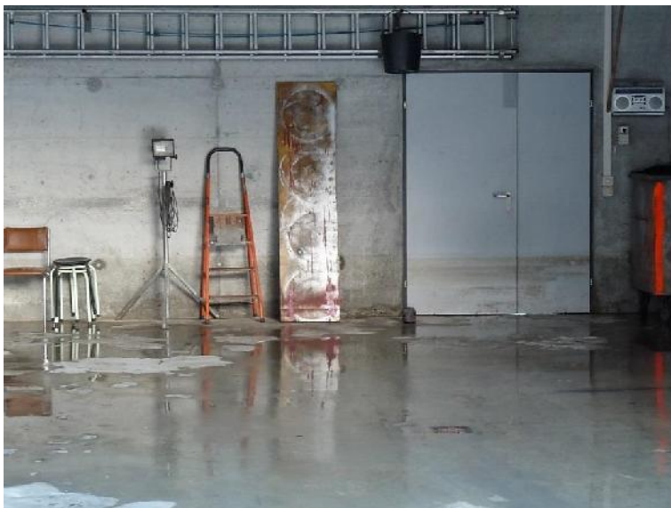
Überschwemmung im Industrie- und Gewerbeareal: Gemäss den Spuren an Wand und Türe stand das Wasser in dieser Fahrzeughalle gegen 60 cm tief. (Foto: IRV/VKF, 12.01.2016)
